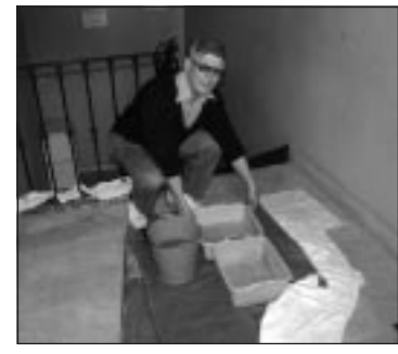
Infiltrazioni a Villa Olimpia
